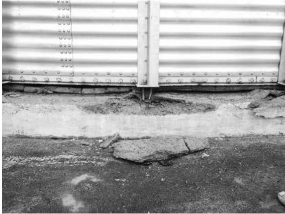
Фото 1. Руйнування бетону фундаменту силосу і відсутність підливки бетону під ребром жорсткості
