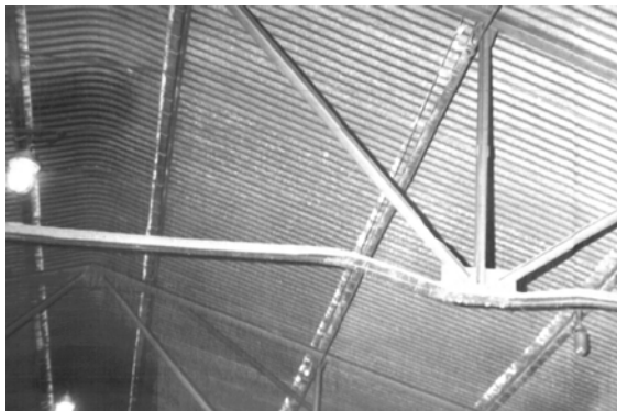
Фото 7. Втрата загальної стійкості елементів ферм покриття зерносховища, яка виникла під дією удару від технологічного обладнання
