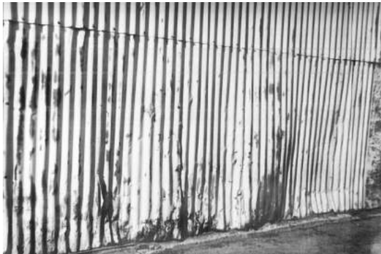
Фото 3. Корозія огорожувальних конструкцій зерносховища
